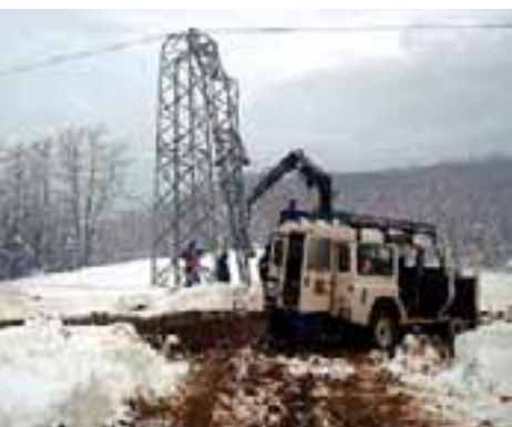
Jedan od čelično rešetkastih stupova dalekovoda 35 kV DV Tušmer - Generalski Stol kao stup od papira
