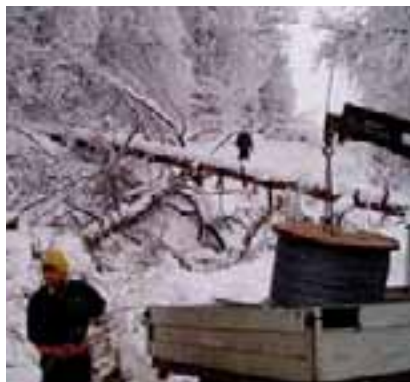
Radno vozilo probilo se do trase dalekovoda Cerovac - Trebinja na kojoj su, zbog rušenja stabala, stradala tri stupa i 300 metara vodiča
