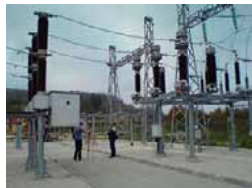
...ispod vodova u dalekovodnom polju rasklopnog postrojenja 110 kV HE Lešće
