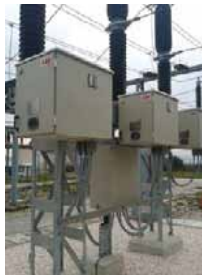
Ugrađeni prekidač tipa ABB-a LTP145D
