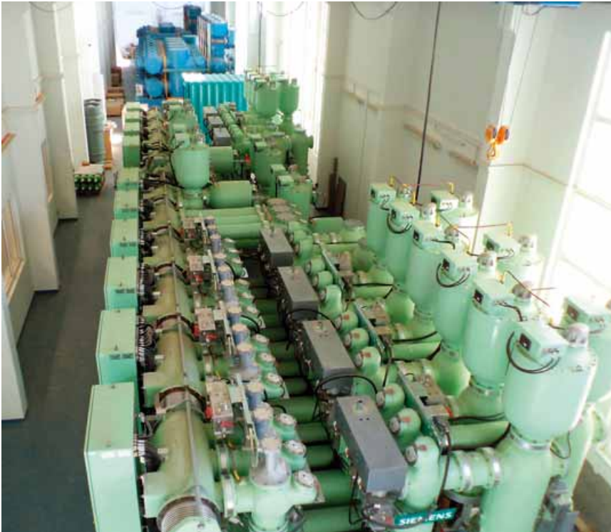
Moćno suvremeno GIS postrojenje 220 kV, prvo takvo u Hrvatskoj, i GIS postrojenje 110 kV
