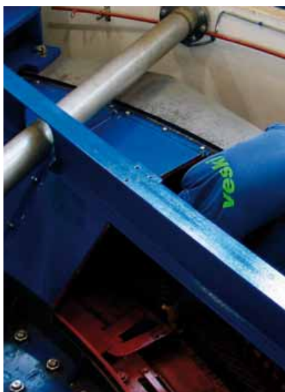
Instaliranje i parametriranje davača za mjerenje zračnog raspora na generatoru A obavila je ekipa tvrtke Veski
