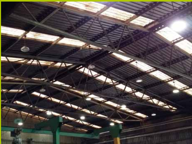
ELKA: PROJEKT ENERGETSKE UČINKOVITOSTI U RASVJETNOM SUSTAVU POGONA
