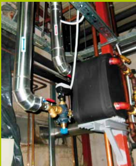
PPK KARLOVAČKA MESNA INDUSTRIJA: MODERNIZIRANI POSTOJEĆI SUSTAVI
