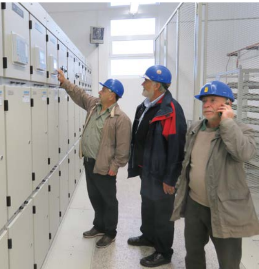
↑ Interni tehnički pregled TS Gerovo
