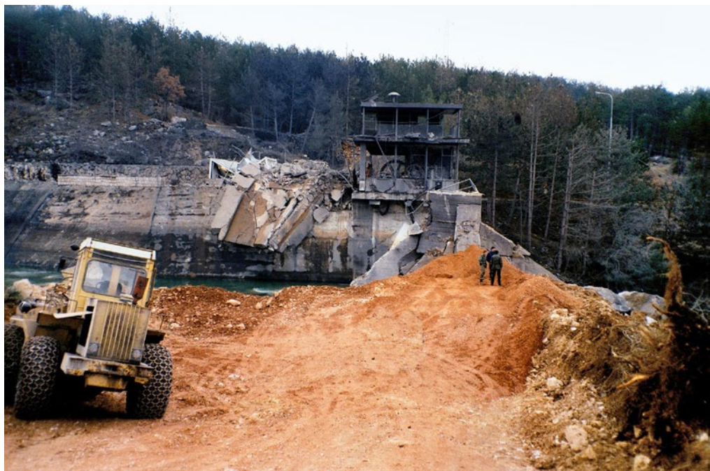
↑ U eksploziji je oštećena preljevnj građevina i injekcijska galerija
