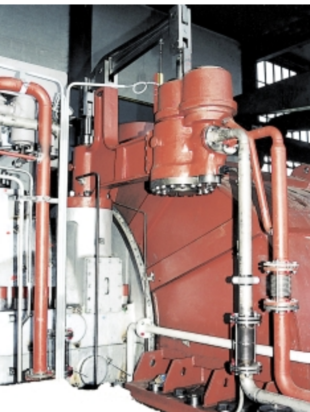
Glavni parni zasun (dovod pare u turbinu)
