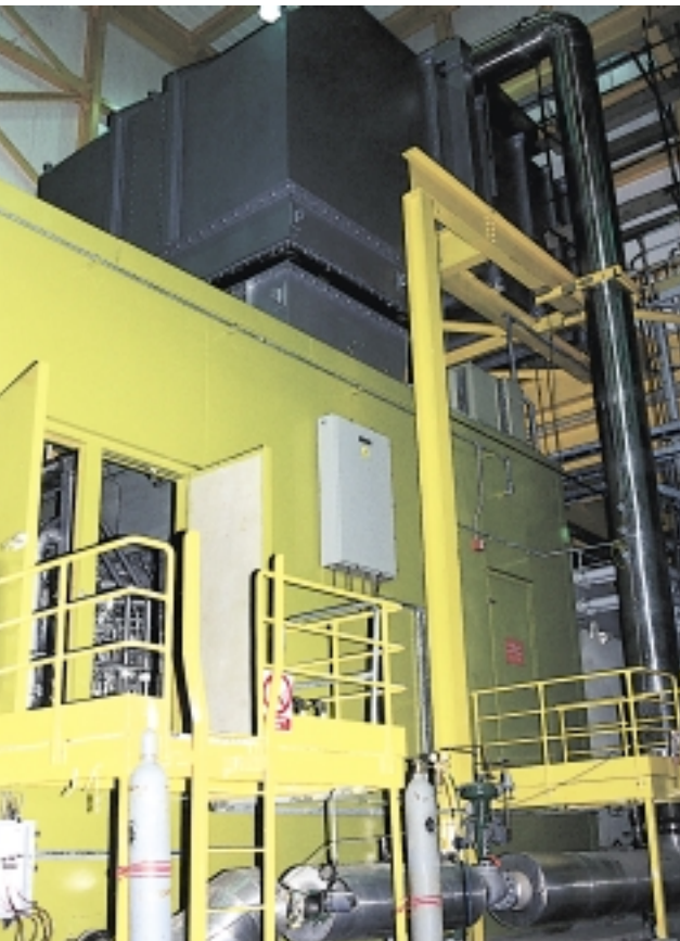
Plinsko postrojenje – dvije turbine po 70 MW (šest komora izgaranja, takozvani suhi postupak NOx spojeva, pogon na plin ili ekstra lako loživo ulje, temperatura izlaznih plinova 595 stupnjeva Celzijusovih)
