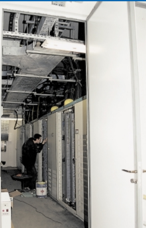
Centralni sustav upravljanja i vođenja (DCS), mozak cijelog postrojenja
