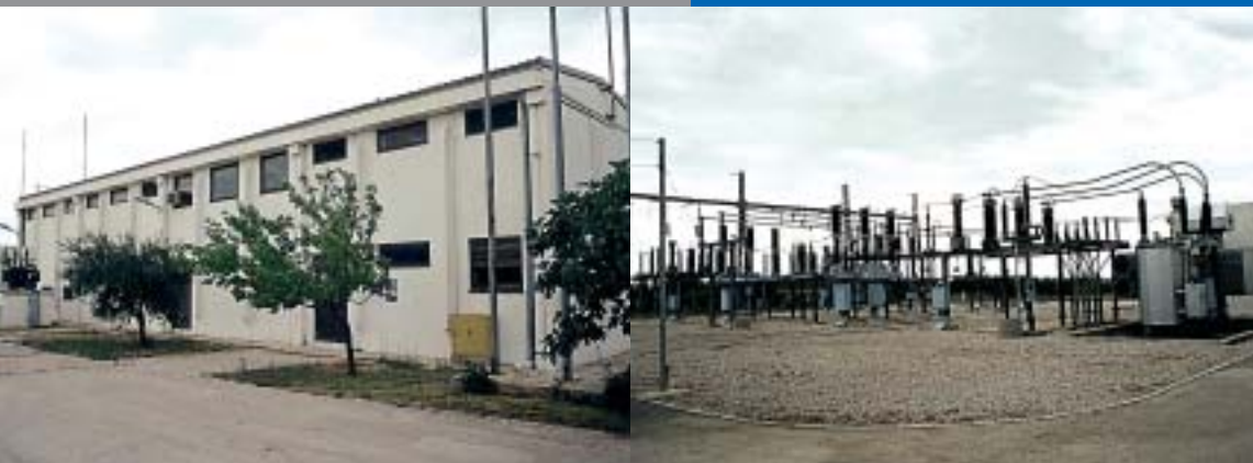
TS 110/10 kV Benkovac: kao i u Obrovcu ni ovdje nema posade!
