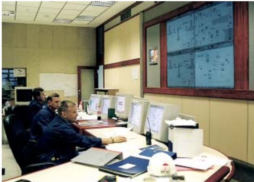
Upravljačka soba novog postrojenja: vođa smjene Ivan Sabol i strojari Mario Krajačić i Vladimir Gelo
