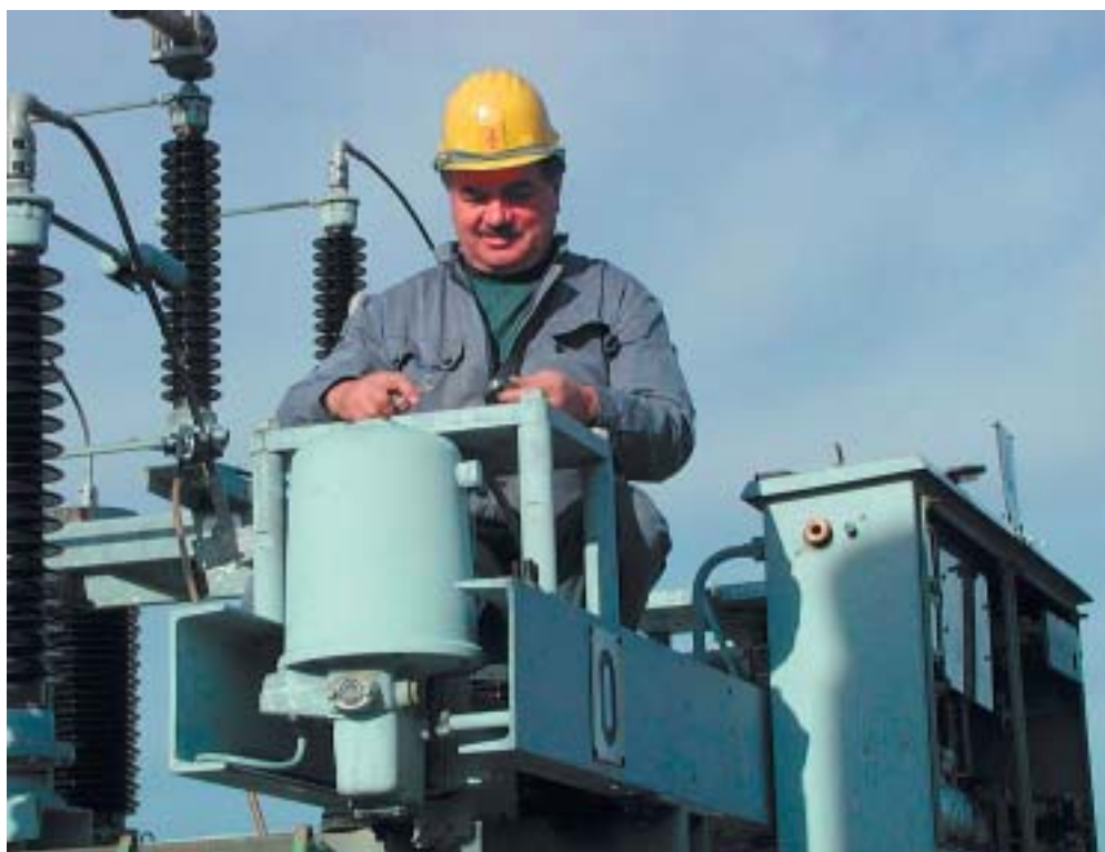
Ante Lacić obavlja reviziju na izolatorima 123 kV SF6 prekidača mrežnog transformatora HE Dubrava
