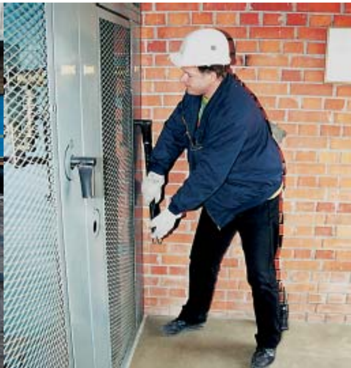
Nakon popravaka Miroslav Činčec ponovno uključuje sklopke u KTS
