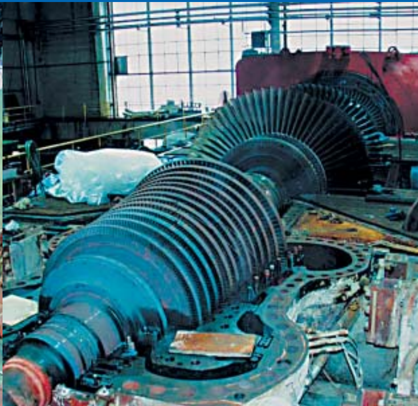
Srednjetlačni i visokotlačni dio turbine
