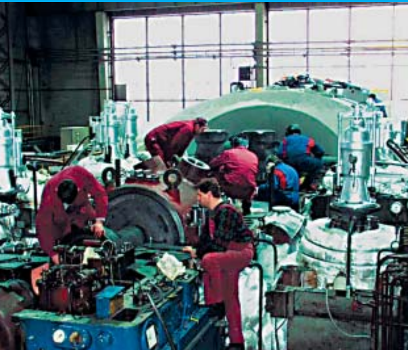
Tijekom remonta, kako se vidi i na ovoj slici, radnici TE Plomin 1, ali i vanjski izvođači imali su pune ruke posla jer su se uz planirane, nakon otvaranja i pregleda postrojenja, pojavili i dodatni složeni poslovi koji se nisu mogli prije predvidjeti
