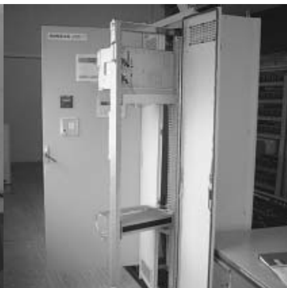
Ormar procesne stanice i lokalne procesorske jedinice agregata i ormar releja automatike
