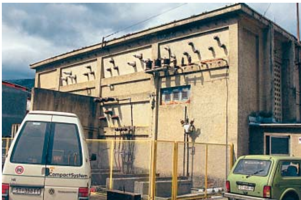
TS 35/10 kV Sinj 1 dobro se drži, ali uskoro će biti pomladena, jer vrijeme je...
