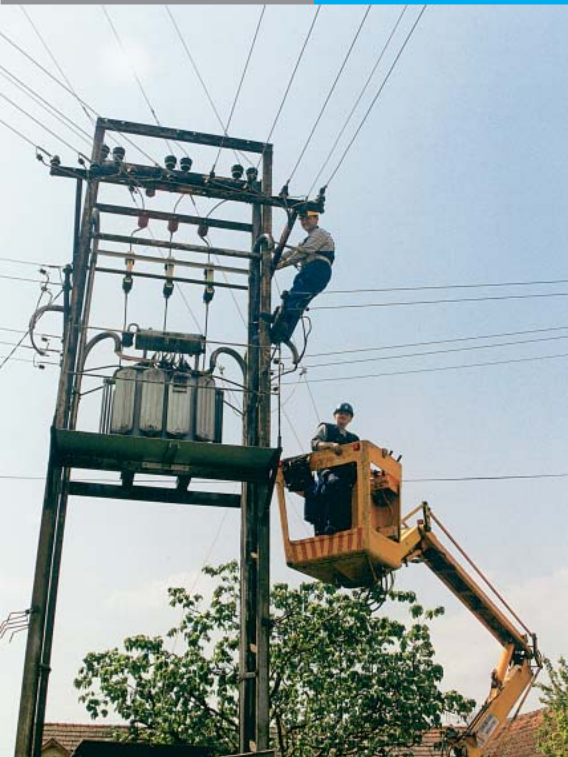
Monteri Pogona Slatina Dubravko Tomac, Valentino Taradej i Davor Šebjanić na rekonstrukciji visokog i niskog napona u ŽSTS 10/04 kV u selu Bakić
