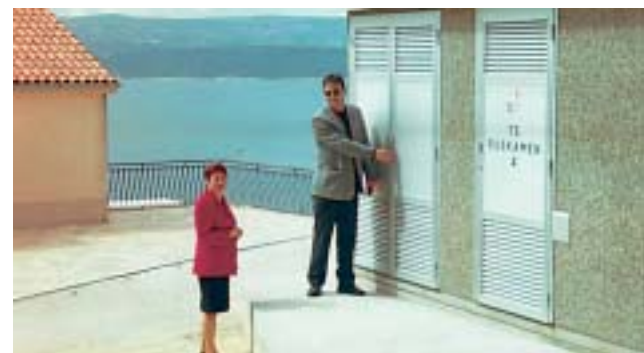
Luca Ergić, građevinski inženjer zadužena za nadzor izgradnje i Tonči Mimica, rukovoditelj Odsjeka tehničkih poslova u Pogonu Omiš uz TS Ruskamen 4
