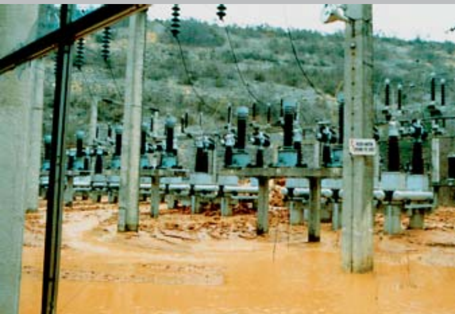
U rasklopištu je kroz okno drenažnog kanala izbio gejzir kroz koji je voda sukljala u visini od četiri metra
