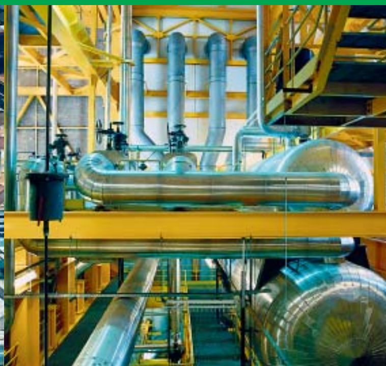
Otplinjači i spremnik napojne vode u kotlovnici
