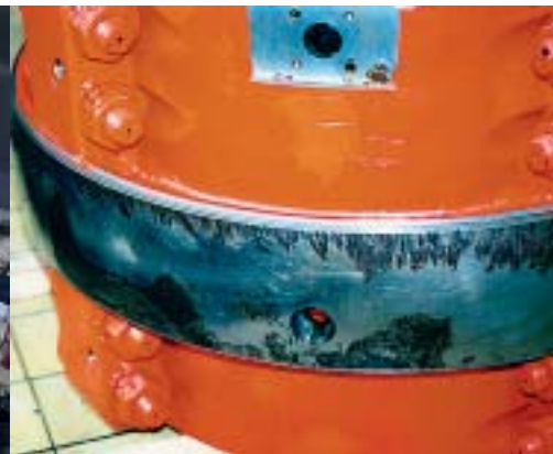
Korozivna oštećenja na generatorskom ležaju u HE Dubrava
