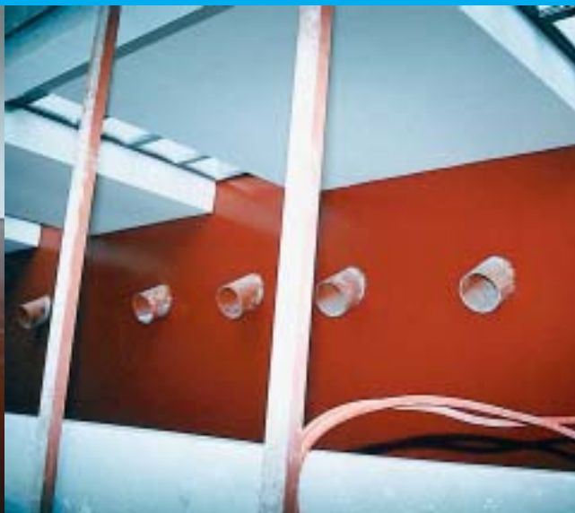
Pogled odozgo na kabelski prostor u zgradi srednjeg napona
