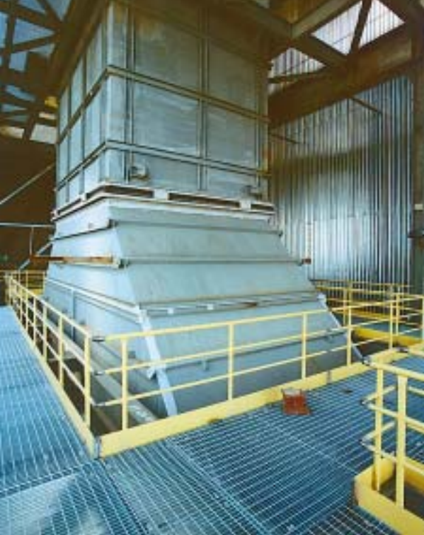
Prigušivač zraka na kotlu na otpadnu toplinu (na izlazu iz kotla na otpadnu toplinu - prije dimnjaka)
