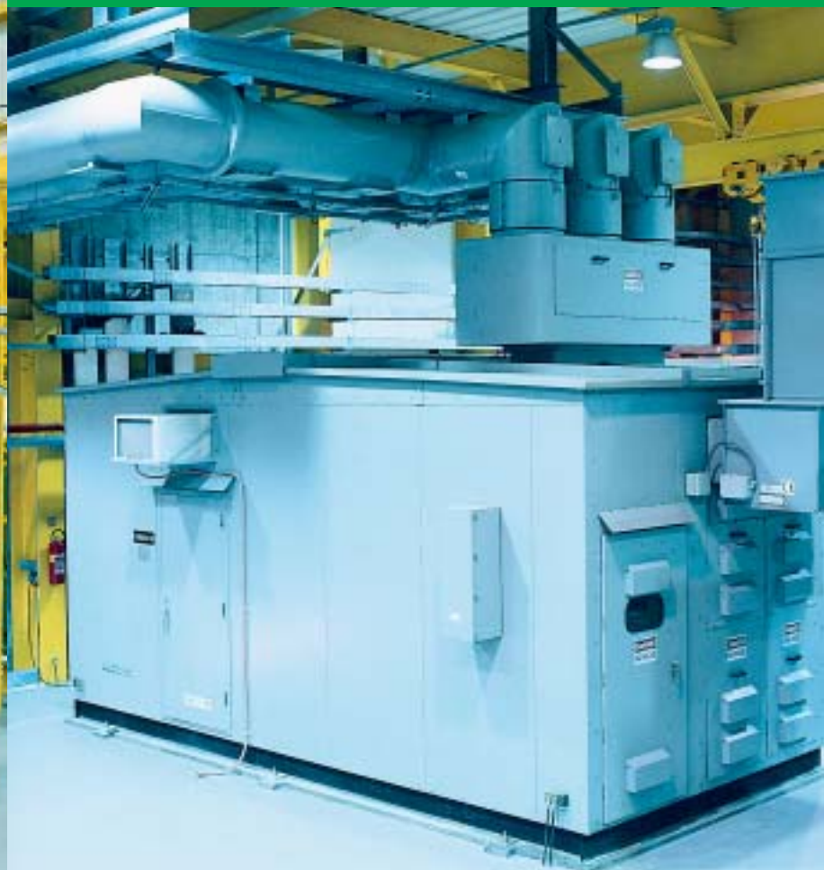
Blok transformator plinske turbine
