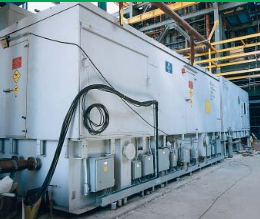
Segment uljnog postrojenja plinske turbine
