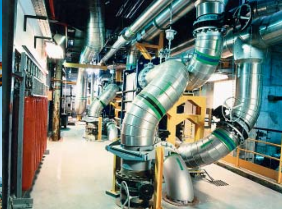
Sustav zatvorenog kruga rashladne vode (s lijeve strane su protupožarni uređaji za gašenje požara ugeneratoru parne turbine)
