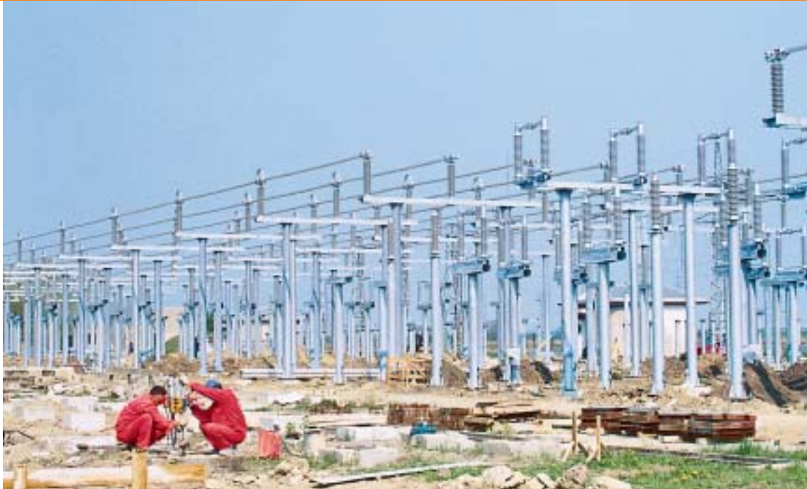
Gotove su glavne sabirnice 110 kV postrojenja
