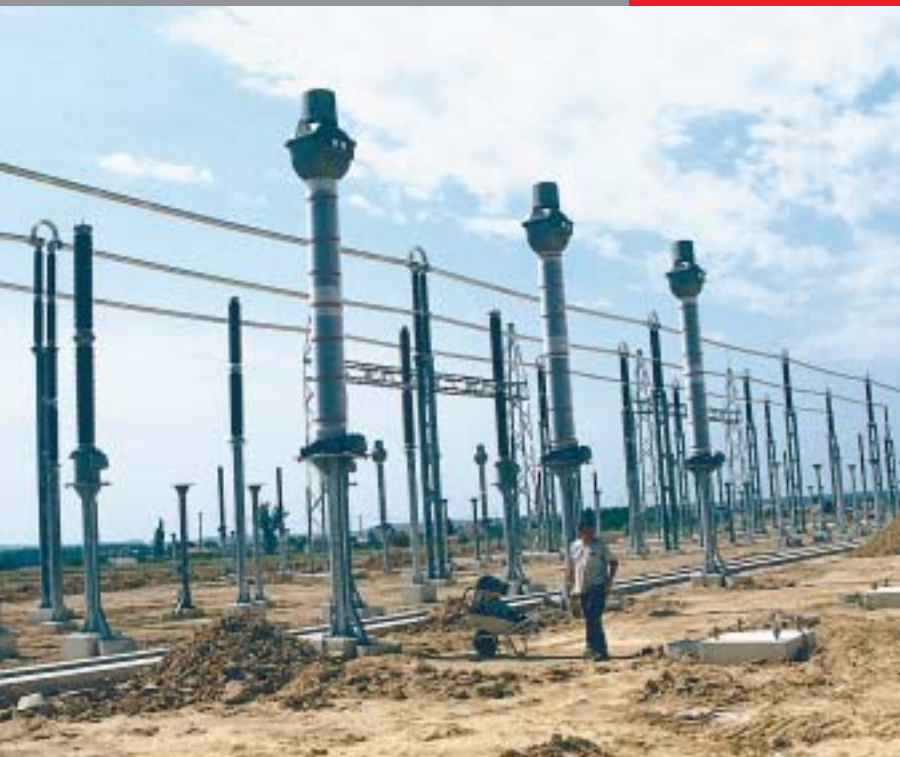
Naponski mjerni transformatori u RP 400 kV
