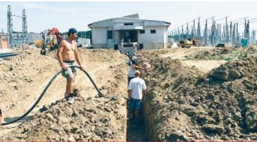
Radovi na kabelskoj vezi zgrade upravljanja i pomoćnih pogona sa TS 20(10)/0,4 kV
