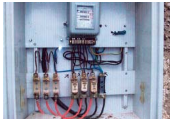
Primjer krađe električne energije: brojilo je bez poklopca, a s osigurača pojedine žice idu u brojilo, a druge izravno na trošila, što znači da se dio električne energije troši mimo mjernog uređaja
