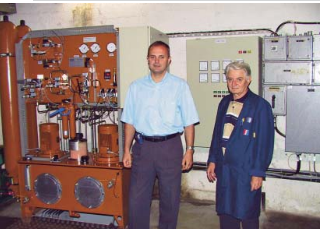
... i ispred tlačnog i regulacijsko-upravljačkog hidrauličkog sklopa novog sustava turbinske regulacije agregata
