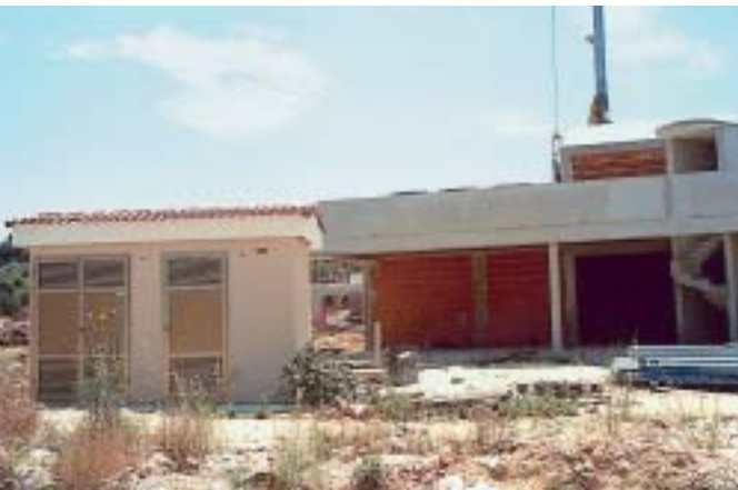
Transformatorska stanica u Rogoznici izgrađena za potrebe škole čija je izgradnja u tijeku
