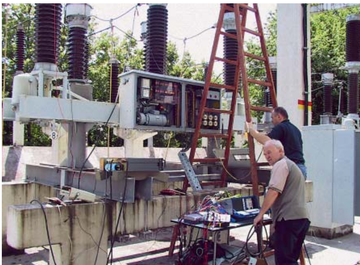
Na rasklopištu 110 kV obavlja se velika revizija SF6 prekidača
