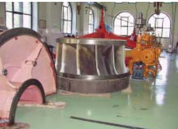
Unutrašnjost HE Ozalj 1. Dok traju radovi na uređenju odvodnog kanala obavlja se i remont postrojenja
