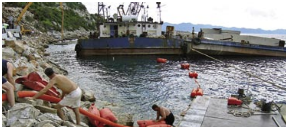
Novi dio kabela na jastucima će doploviti do mjesta rada i mjesta spajanja sa starim kabelom
