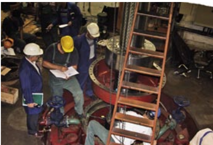
I tehnički rukovoditelj HE Rijeka Josip Dragičević većinu vremena provodi u strojarnici – za koji trenutak započet će ispitivanje centričnosti osovine ručnim okretanjem
