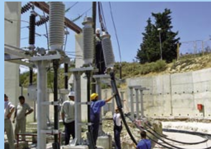
Podižu se 110 kV kableske glave u vanjskom 110kV postrojenju TS 110/10 kV Split 3
