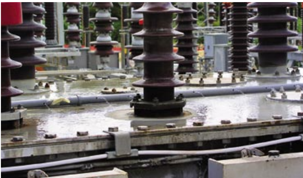
Krov transformatora o kojem je ovisio skoro cijeli Split - hladi se zalijevanjem vodom
