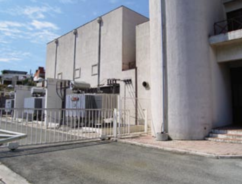
Nova TS (110)35/10 kV Dujmovača, kojom će se riješiti napajanje cijele gradske jezgre i u idućih 30 do 40 godina neće biti ograničenja za razvoj tog dijela grada
