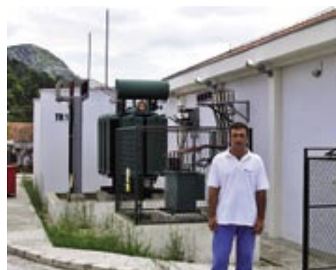
Antun Kraljić, zamjenik rukovoditelja Pogonskog ureda, uz prije nekoliko godina izgrađenu TS 35 /10 kV Ston, priželjkuje više takvih objekata
