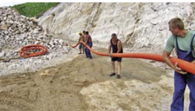
Kabel je zaštićen u plastičnoj cijevi
