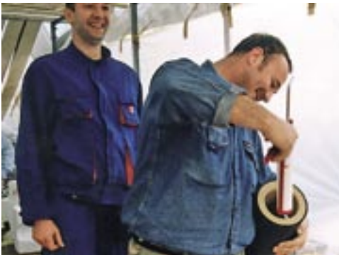
U jednoj od tri spojne jame, spojna cijev podmazuje se silikonom kako se ne bi oštetio kabel
