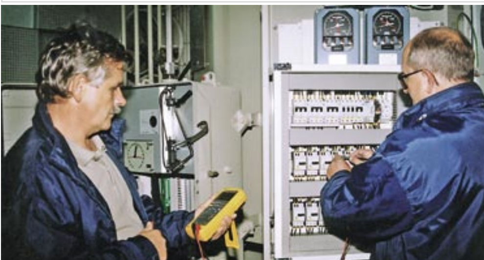
Tomislav Lukunić i Branimir Bednaž iz Končar DIST-a provode funkcionalno ispitivanje svih zaštita na transformatoru njihove proizvodnje – buholz relej, zaštitni relej sklopke, odušnik transformatora, temperaturu zaštite....
