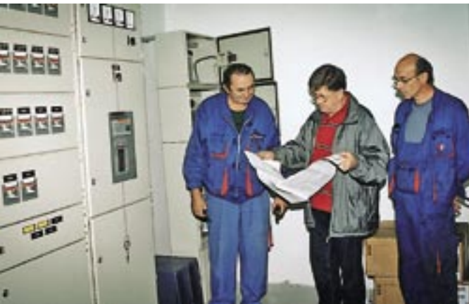
Miroslav Hadžić, poslovođa za održavanje trafostanica, Dragutin Kos, VKV elektromonter i Zdenko Felatov, VKV strojobravar, prisustvovat će i ako ustreba pomoći pri ispitivanju zaštite 110 kV transformatora, kojeg će ubuduće i održavati
