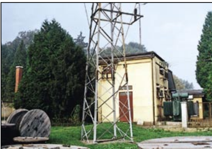
Iza poslovne zgrade nalazi se i TS 35/10 kV Novi Marof 1, okružena njegovanim zelenilom
