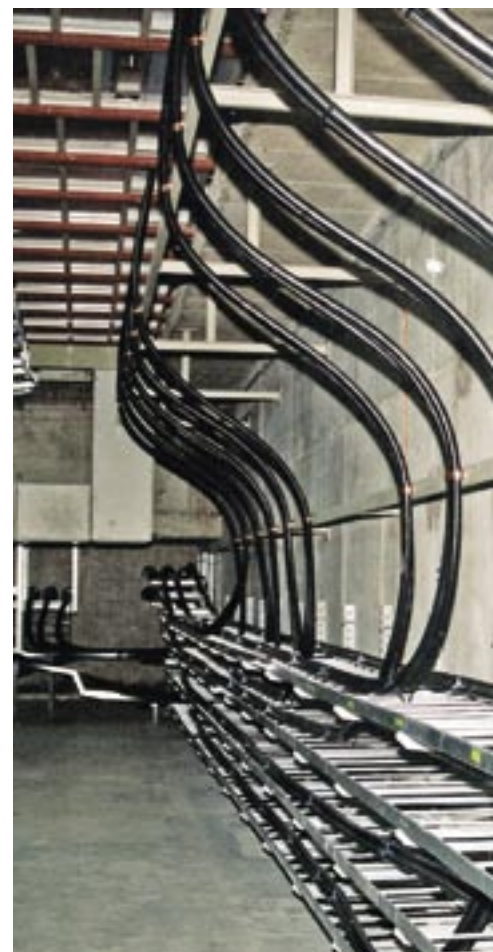
Sredjenaponski kabeli na policama u TS Savica
