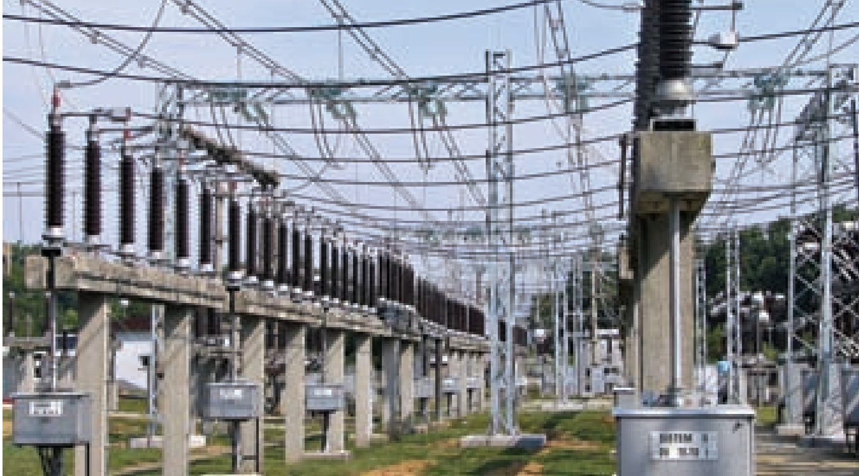
Sabirnički 110 kV sustav u TS 110/30 kV Resnik – nakon rekonstrukcije
