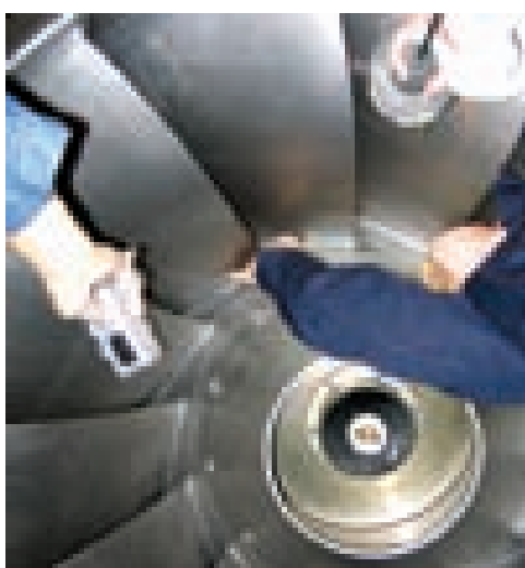
Pregled radnog kola ugrađenog 2005. godine
