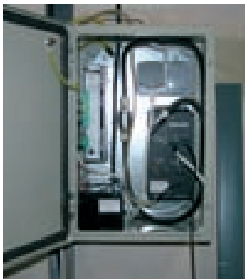
Instalirani MR400 radijski modem s pripadnim sustavom napajanja zajedno s baterijom za 12 sati autonomije rada i zaštitom od atmosferskih pražnjenja
