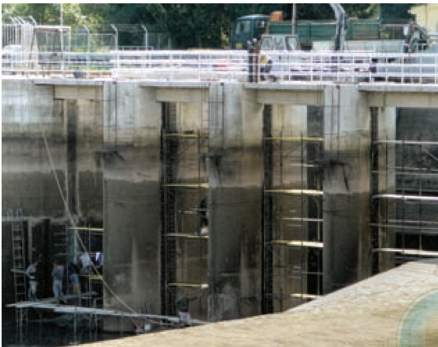
Ugrađena je i vodilica pomoćnih zatvarača te letvica za mjerenje vodostaja
