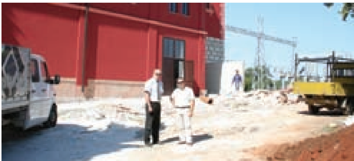
Koordinator u Službi za održavanje Elektroistre Danilo Gambaletta ispred novouređene rekonstruirane TS 110/10(20) kV Vinčent u društvu kolege iz Ekonomske službe
