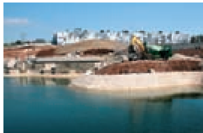
Pogled na novoizgrađenu Tvornicu duhana Rovinj i Istragrafiku Rovinj u Kanfanaru za koje je trebalo osigurati snagu od 9 MVA
