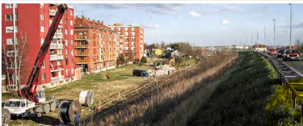
Polaganje 110 kV kabela od TS Osijek 3 do buduće TS Osijek 4 na osječkoj južnoj zaobilaznici
