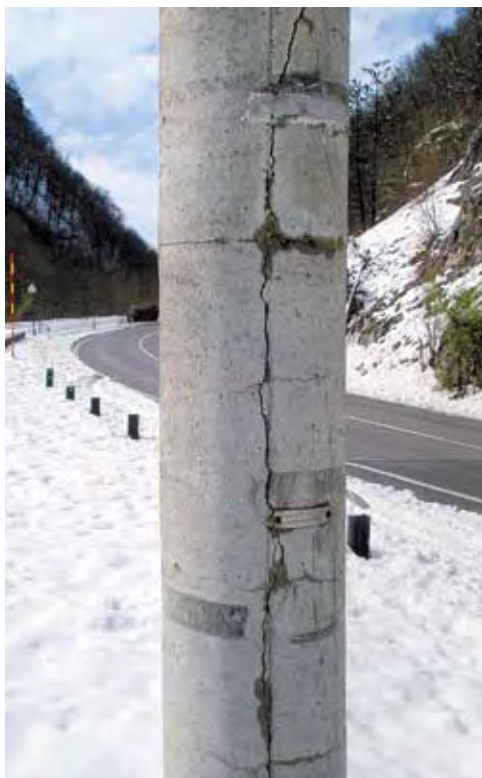
Na području Pogonskog ureda Krapina napukao je i čak betonski stup
