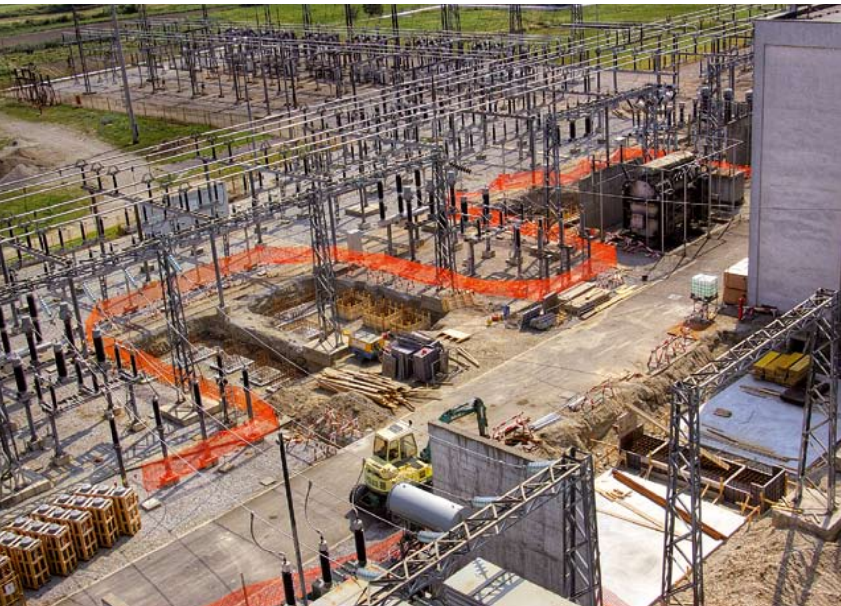
Postolje energetskih transformatora i ostale visokonaponske opreme – iz ptičje perspektive
