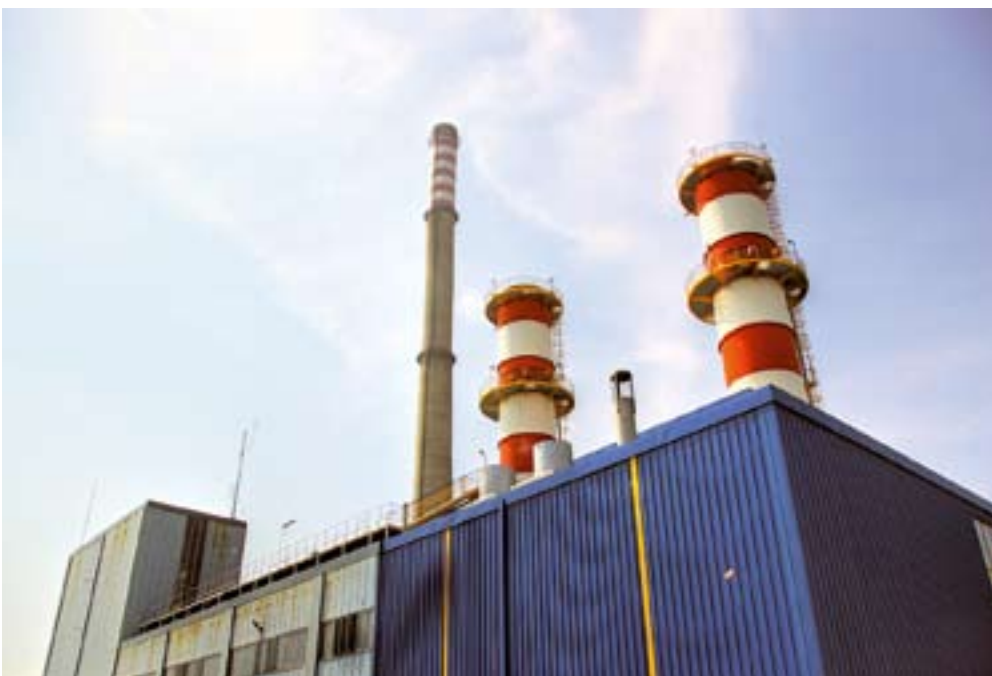
S užarenog krova snimili smo izbliza i postojeće dimnjake TE-TO, uz koje će uskoro osvanuti još jedan ...
