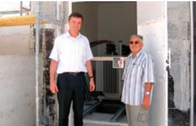
Domagoj Milun i Miroslav Bem pokazuju novu TS O.Gornji 9, koja će značajno rasteretiti okolne trafostanice
