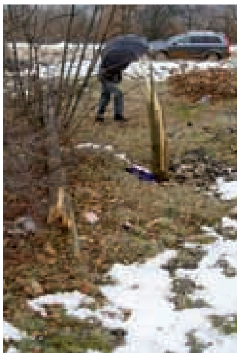
Slomljeni drveni stup, kojeg su povukli vodiči
