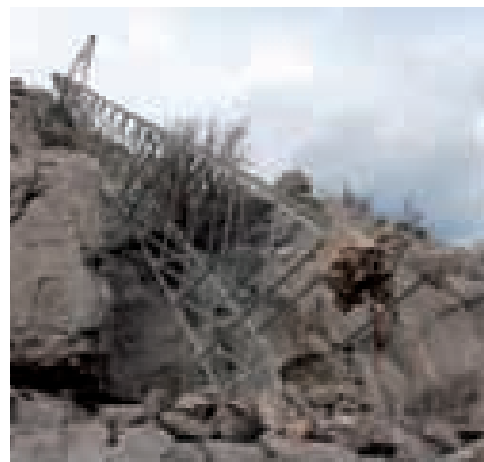
Ni čelična grdosija zabetonirana u čvrstoj stijeni nije izdržala nalete orkanske bure
