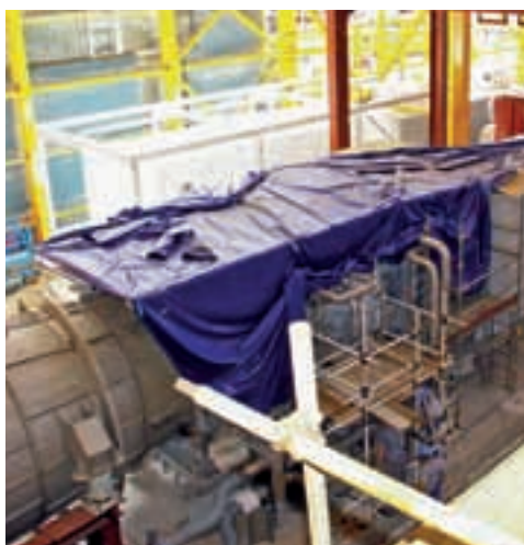
Pokrivena plinska turbina i njen generator
