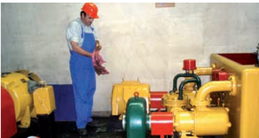
Čišćenje, zamjena i podešavanje opreme turbinske regulacije obavlja dio posade zadužen za strojarsko održavanje, među kojima je i Nikša Šimunović
