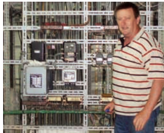
Ovdje se, kaže Mišo Bonačić, obavlja skidanje stare elektroopreme upravljanja koja nije u funkciji i priprema podloge za revitalizacijske zahvate
