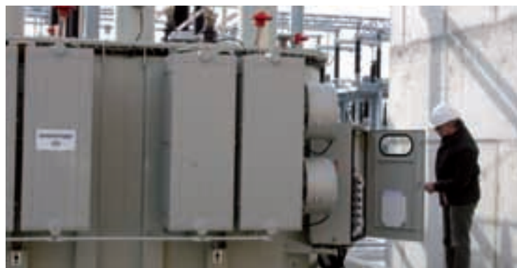
Uoči puštanja u pogon novog transformatora, inspekciju je proveo osobno i direktor Prijenosnog područja Osijek Nikola Jaman
