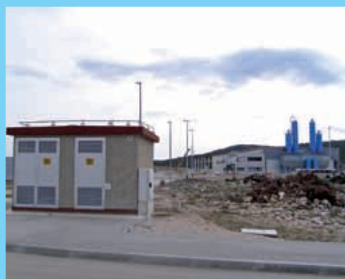
Dio Poslovne zone Novi Stankovci i jedna od novih TS 10(20)/0,4 kV
