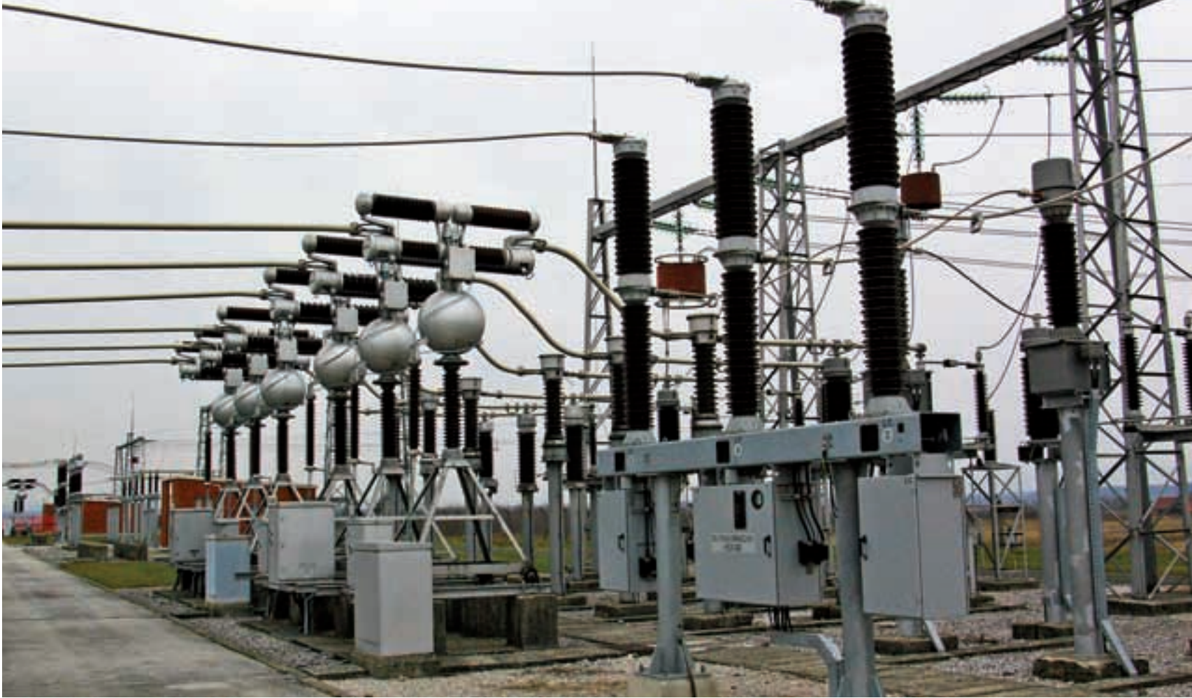
Stari prekidači 3P sa cijevnim spojevima i novi SF6 prekidači sa spojevima Al užeta
