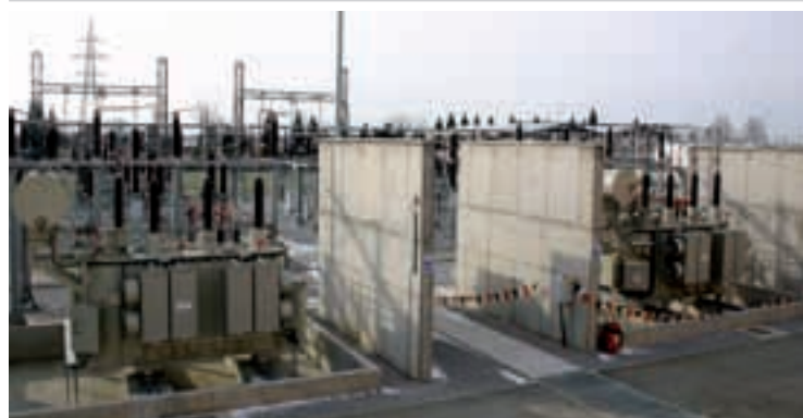
Prvi transformator u TS Osijek 4, koji je pod naponom od 17. srpnja prošle godine, od 16. veljače o.g. dobio je društvo u radu - novi transformator
