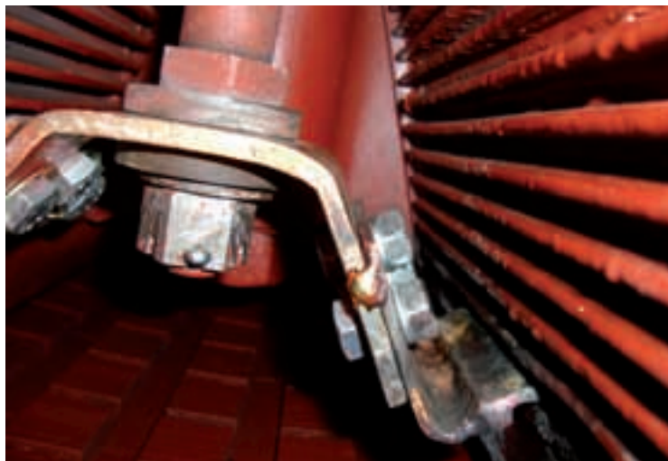
Nakon zaustavljanja agregata, žurno je snimljeno mjesto kvara i odmah je na stručan i siguran način započelo njegovo otklanjanje
