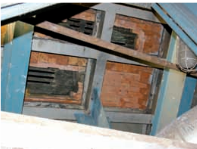
Dok blokovi miruju, otklanjaju se uočeni nedostaci i kvarovi poput, primjerice, ovoga na kotlu 1 A
