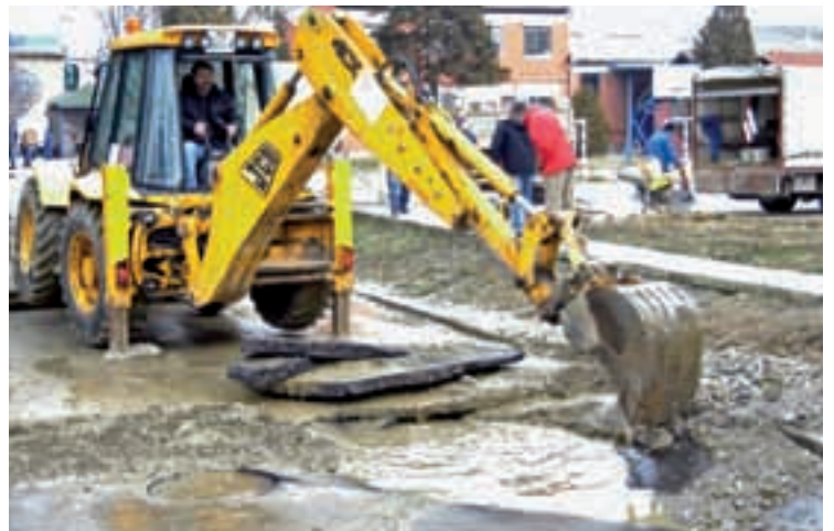
Iz pukotine cijevi magistralnog vodovoda koji prolazi krugom Elektrane-toplane, tri sata je istjecala voda koja je poplavila Toplinsku stanicu, a u strojarnici je dosegla razinu od približno dva metra
