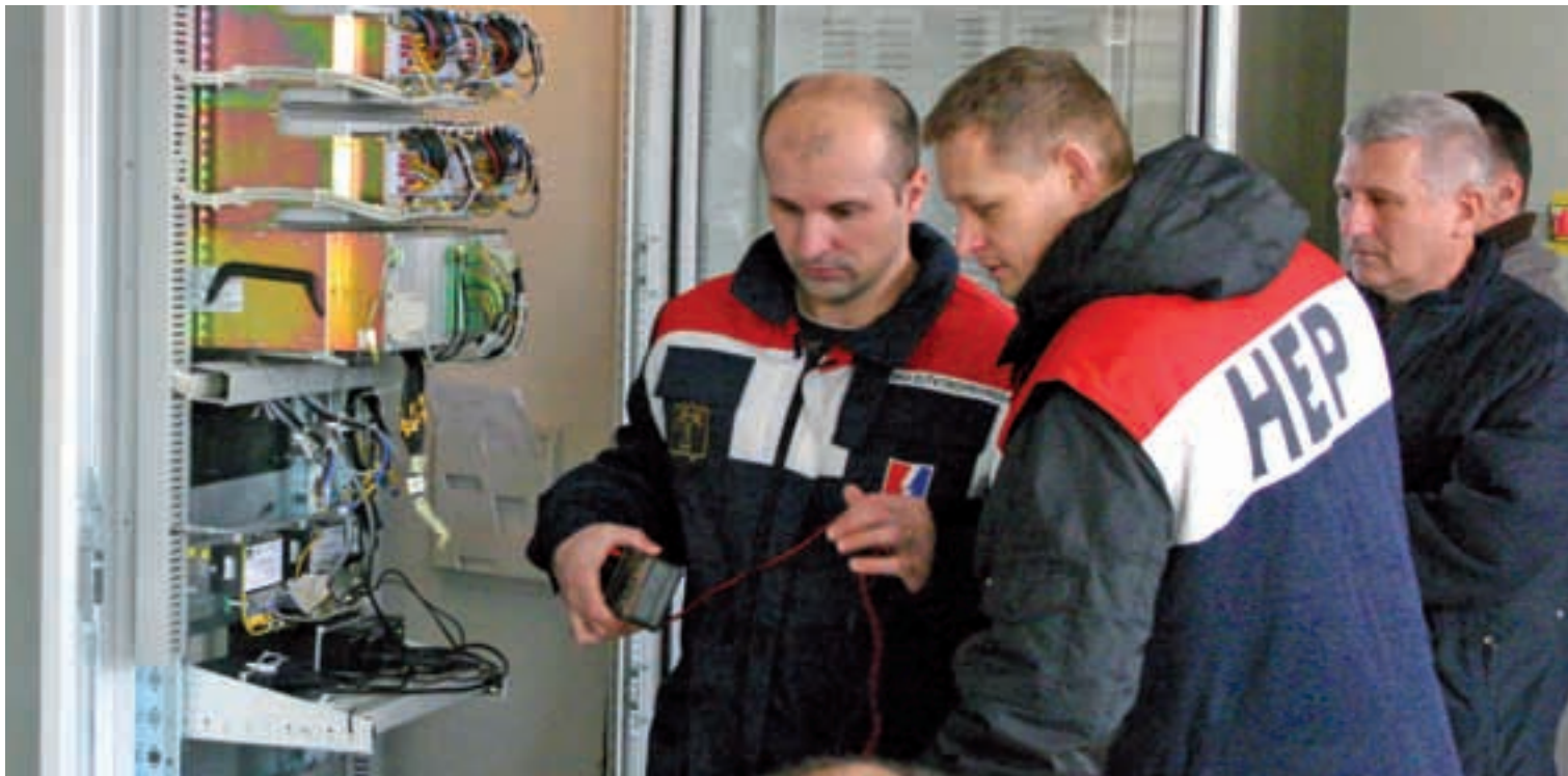
Da bi novi transformator u TS Osijek 4 bio pušten u rad bez poteškoća, zaposlenici Prijenosnog područja Osijek HEP Operatora prijenosnog sustava proveli su potrebna mjerenja u ormarićima
