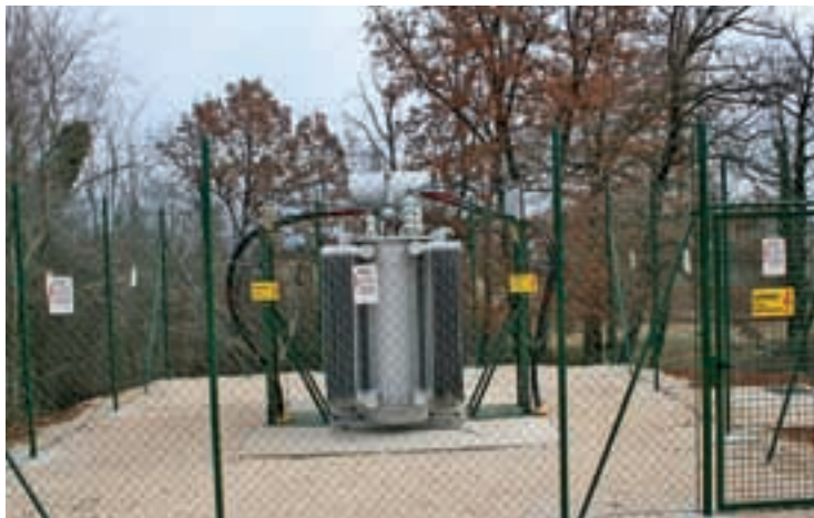
Nova privremena transformacija 20/10 kV povezana 20 kV kablom s elektroenergetskom mrežom Buzeta
