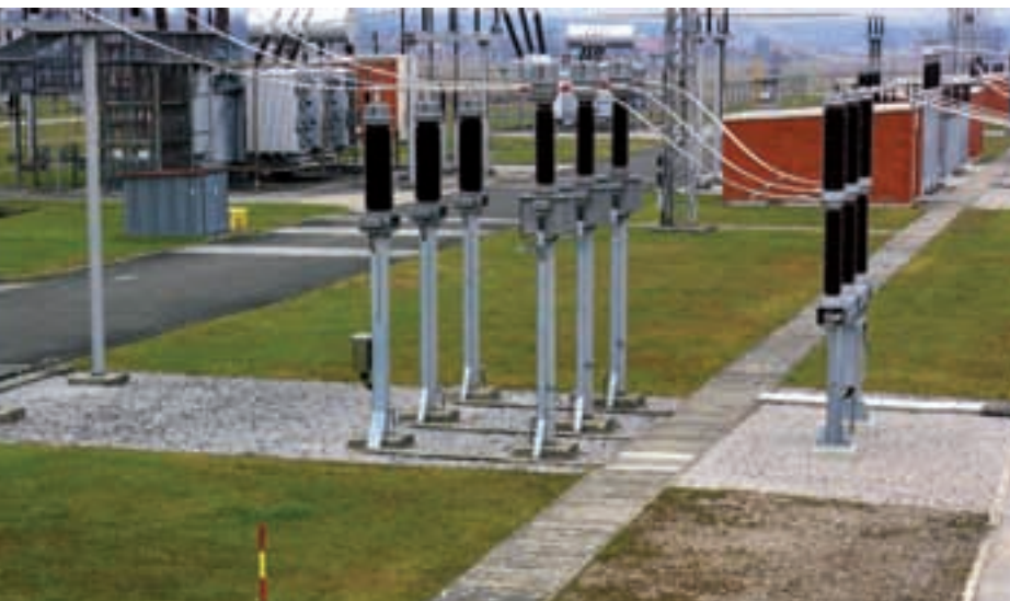
Jedno trafo-polje 110 kV s novim SF6 prekidačima
