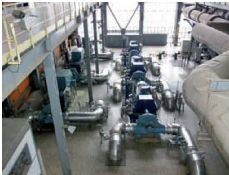
Cirkulacijske crpke toplinske stanice TE-TO, srce vrelovodnog sustava, dobro su funkcionirale
