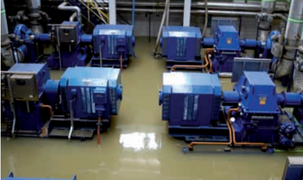
Poplavljen vitalna oprema u Toplinskoj stanici
