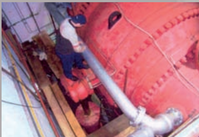
Obilazni cjevovod predturbinskog zatvarača nakon montaže
