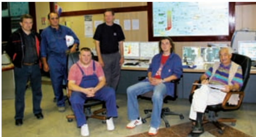
U upravljačnici TE-TO uz video-zid Bloka L: Damir Krajačić - dežurni operater, Damir Kindija - inženjer za preuzimanje iz Đure Đakovića, Ivan Sabol - glavni operater za upuštanje, Mario Kundid - operater, Nikola Vulas - konzultant za preuzimanje i Mario Vinček - pomoćnik rukovoditelja Službe za proizvodnju
