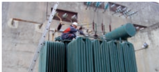
Miljenko Lisica pregledava spojeve na transformatoru
