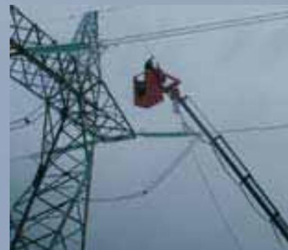
▲ Popravak na DV 400 kV Konjsko – RHE Velebit u rasponu stupova 304 i 305 gdje je zbog nagomilanog leda i nagle neravnoteže sila došlo do pucanja desnog zaštitnog užeta
