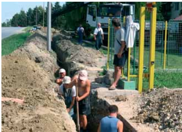
Niču novi kilometri plinovoda u Baranji, radove ne zaustavljaju ni neugodne visoke temperature zraka
