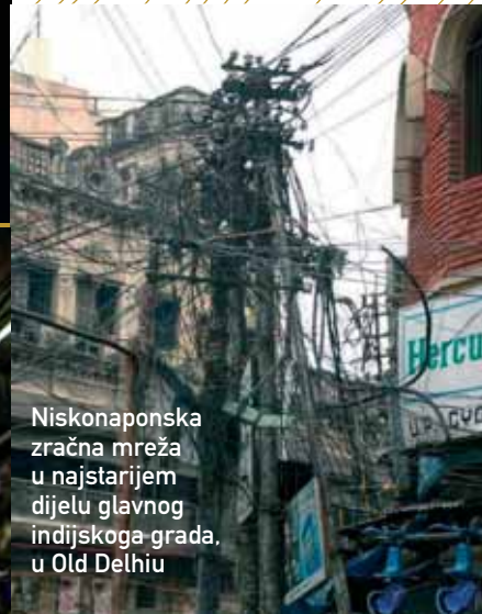
Kabeli se njišu pričvršćeni o krovove kuća, balkona, prozora...
