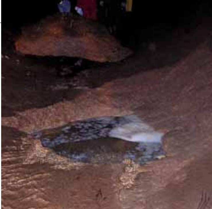
Otkrivena su dodatna neugodna iznenađenja - na stac.7+960 uočeno je urušenje u podu betonske obloge tunela i pukotine koje se šire na obje strane nizvodno, kao i još jedan odlom betona u kaloti
