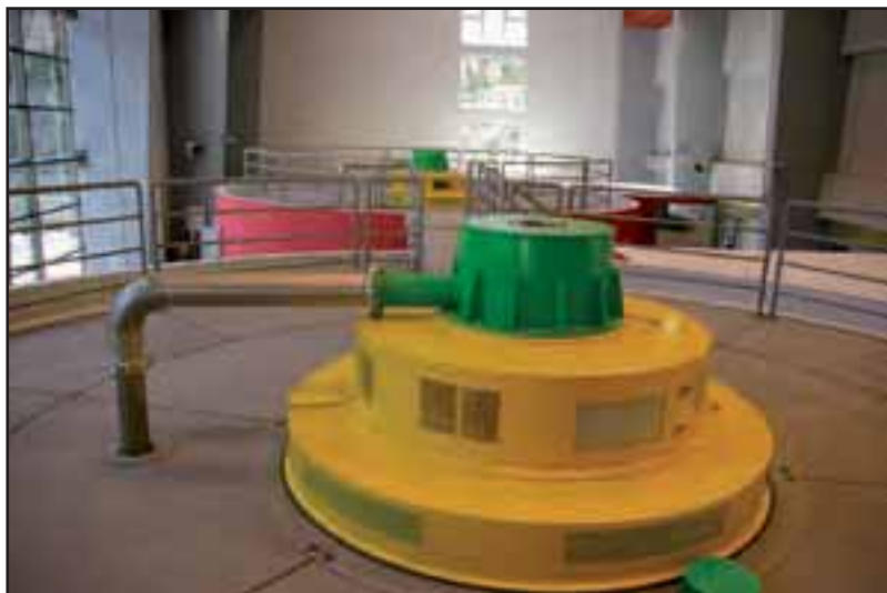
Agregati u strojarnici
