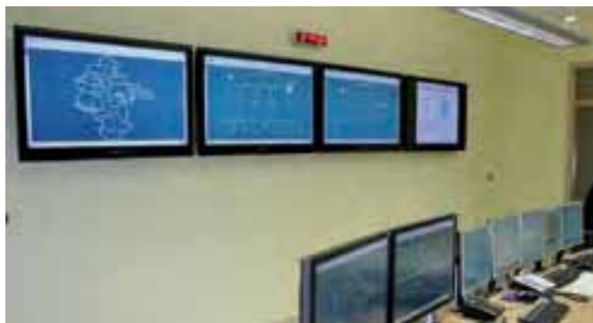
Rad postrojenja Elektre Vinkovci nadzire se na zaslonima
