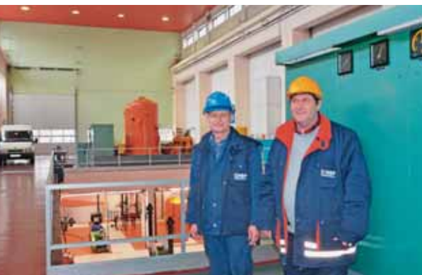
Poslovi održavanja se provode uobičajeno, bez zastoja, kažu Ivan Rajner, koordinator strojarskog održavanja i Mirko Balažinec, poslovođa
