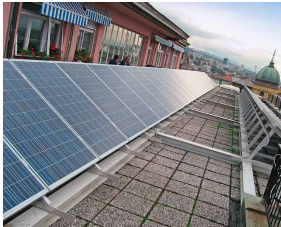
Solarni paneli na zgradi Gradske uprave u Rijeci...
