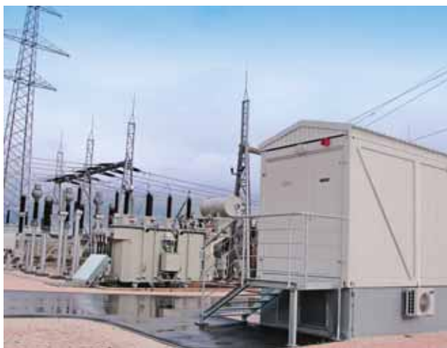
Obnovljeno 220 kV postrojenje ima važnu ulogu u prijenosu električne energije od dalmatinskih hidroelektrana do TS 110/x kV i potrošača
