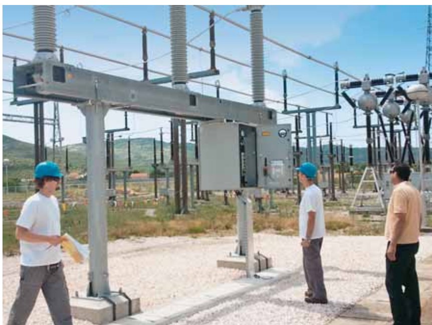
Tijekom tri protekle godine, novim SF6 prekidačima zamijenjeno je deset pneumatskih prekidača postrojenja 220 kV TS Konjsko
