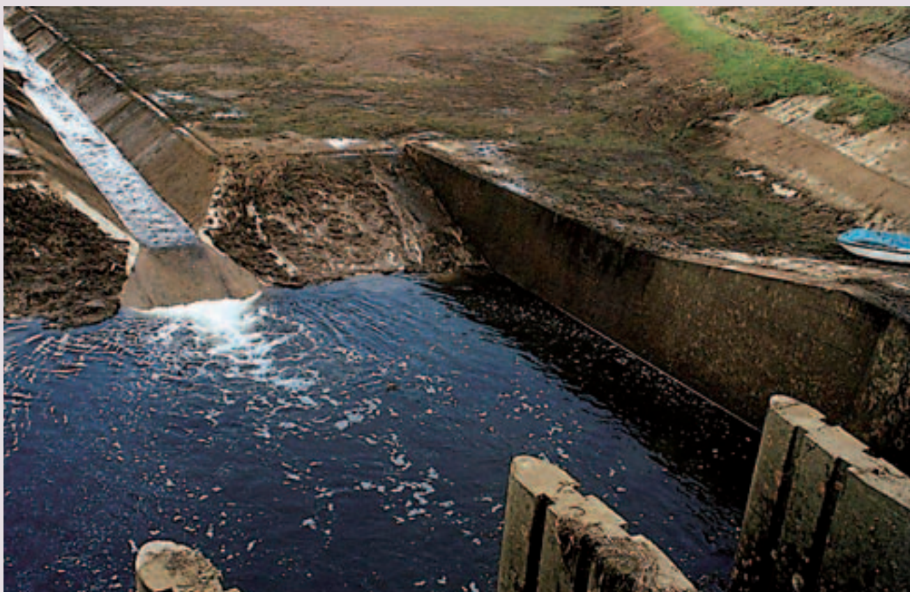
Ispražnjenja akumulacija za dnevno izravnavanje Gusić polje, uz zadržavanje određene količine vode za opskrbu pitkom vodom Senja i otoka podvelebitskog kraja
