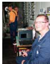
Svi su bili spremni - Branimir Matić u upravljačnici plinsko-turbin-skog agregata broj dva...
