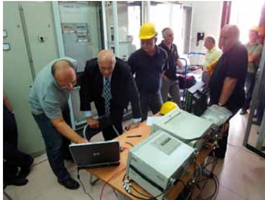
Prvi pregled snimljenih pojava nakon ispitivanja u 400 kV postrojenju TS Žerjavinec - sklapanja dalekovoda u praznom hodu
