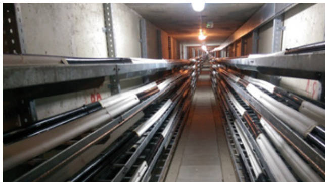
Detalj iz Trafostanice Srđ, najveće investicije HEP ODS-a na jugu Hrvatske
