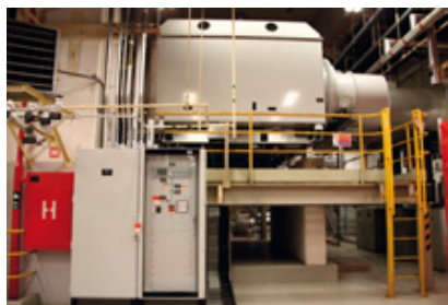
Jedna od značajnijih modifikacija: zamjena glavnog generatorskog prekidača
